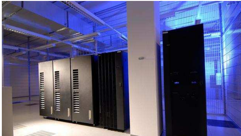
Blick ins Rechenzentrum des IT-Dienstleisters All for One Steeb. Bild: Presse
